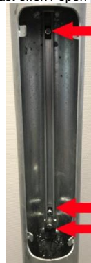
Mast offen / open pole
